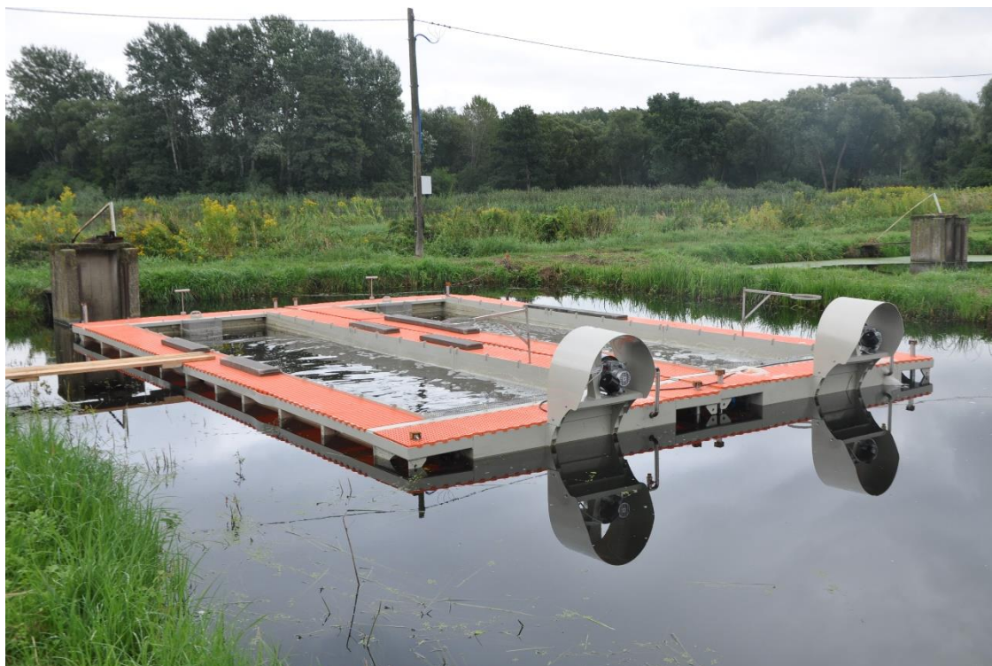
Fot. 1. System SwS składający się z dwóch basenów.
